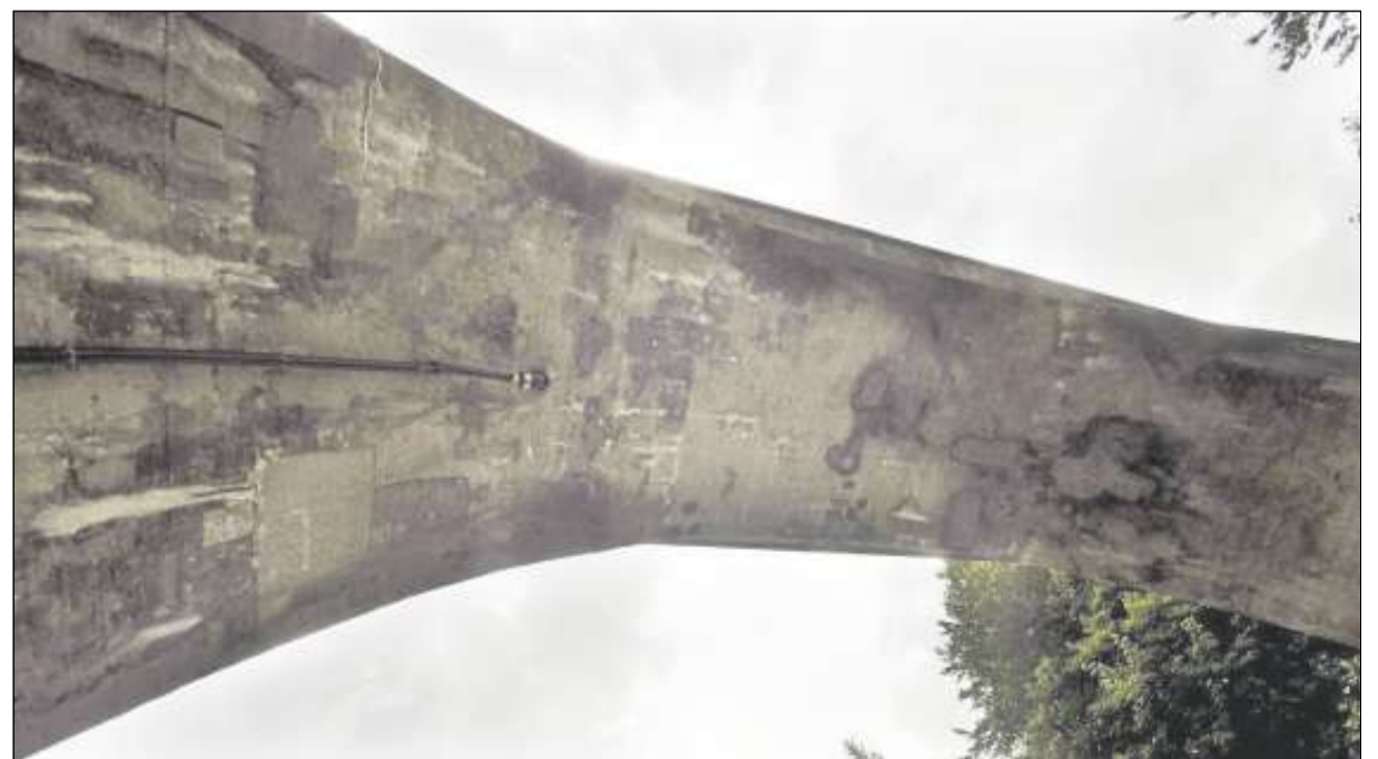
Das Laufmühle-Viadukt auch von unten betrachtet ein Sanierungsfall.
